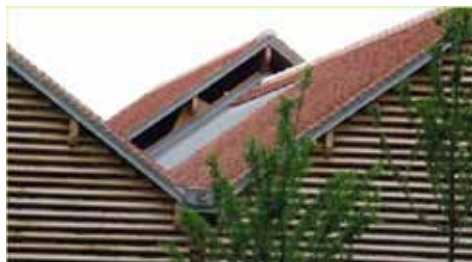
La pose de capteurs entre deux toits limite l'impact visuel.
